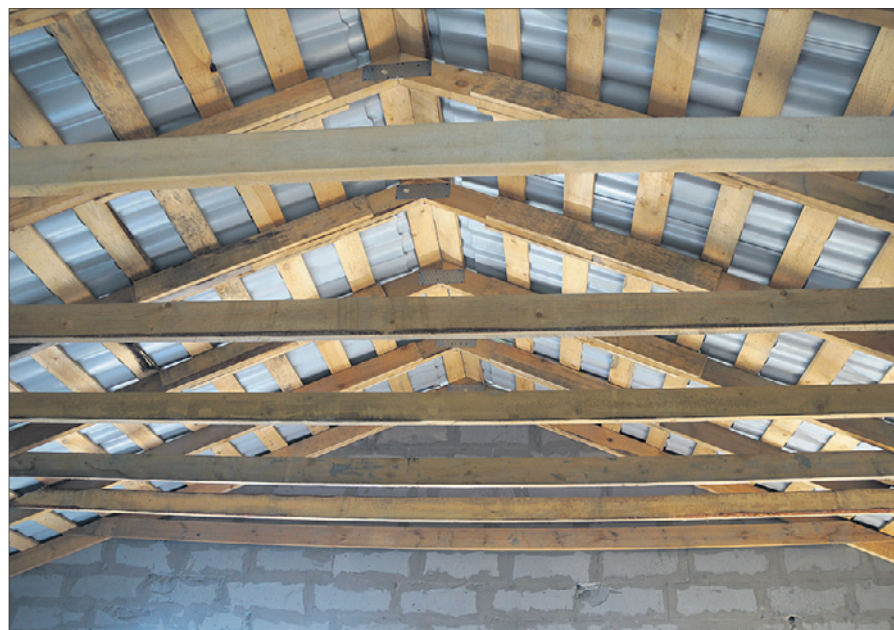
Крыша нуждается в обновлении примерно через 30 лет.
