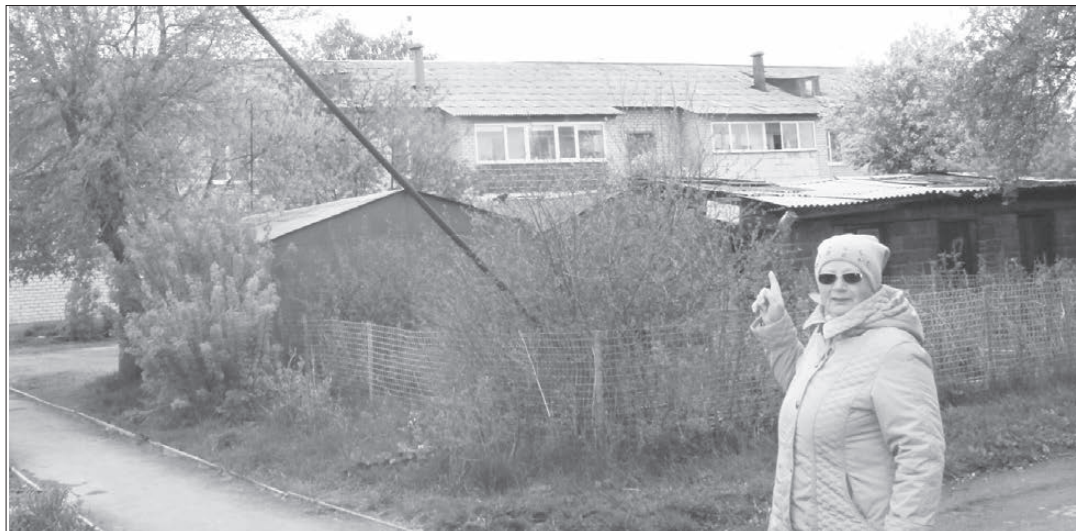
Татьяне Трибунской пришлось за свои деньги ремонтировать крышу после урагана
