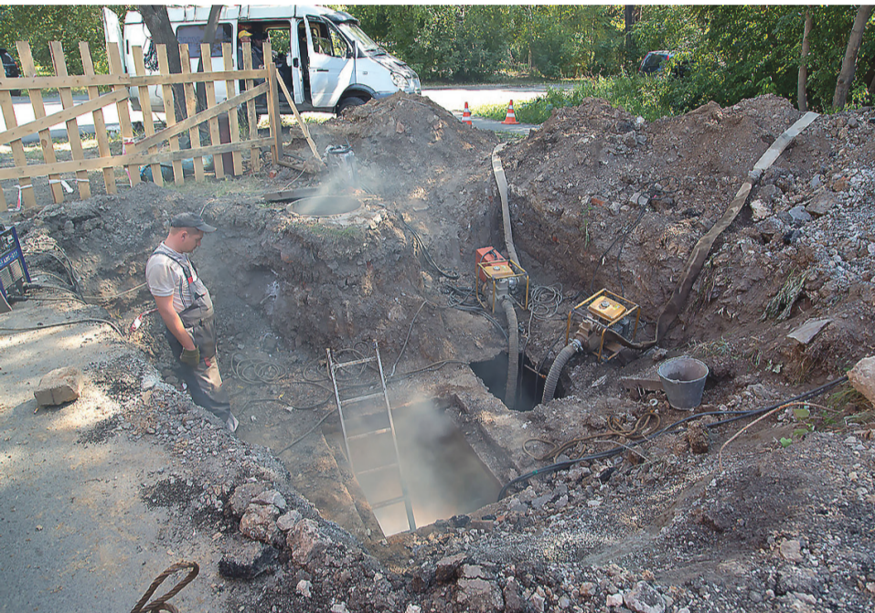
Ведутся работы на участке камеры, расположенной на проезжей части улицы Кузнецкого, дорога перекрыта лишь частично.
