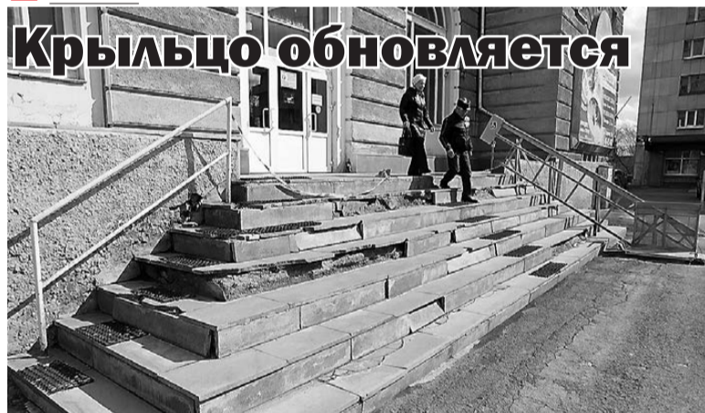
Так выглядело опасное крыльцо до реконструкции.
