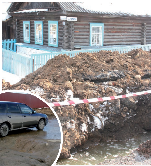
Недавно вода в выкопанной яме начала подмывать грунт. Человек, близко подошедший к ней, может упасть, и красно-белая лента тут уже не спасет.
