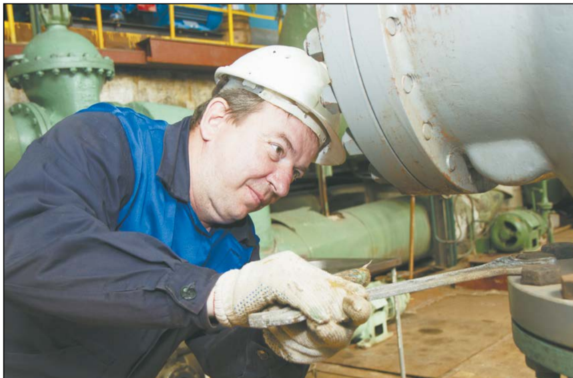
Старший оператор котельной № 1 Алексей Шиллов ревизирует оборудование
