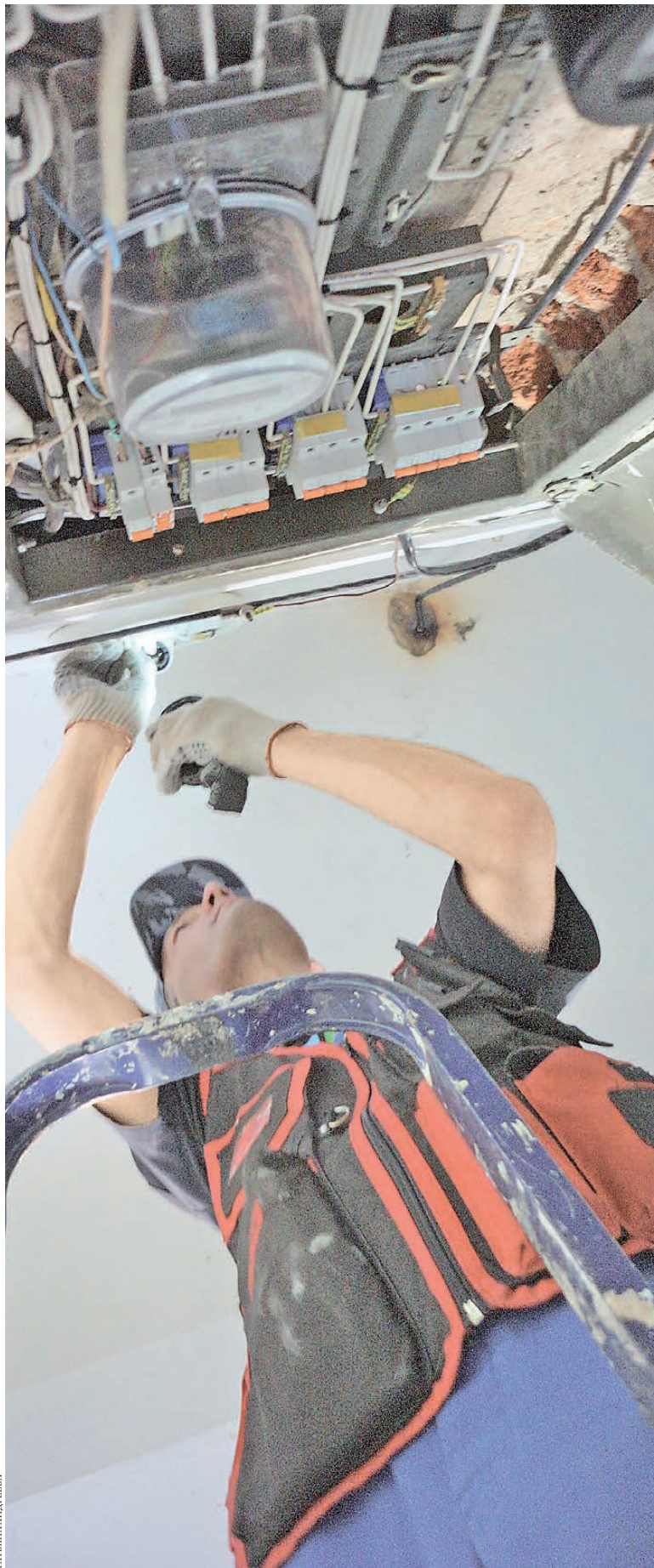
Рачительным собственникам удастся скопить деньги на замену счетчиков и электропроводки в доме.
