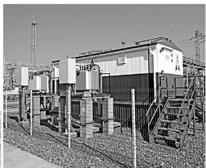
Новая подстанция «Соровская» обеспечит надежное энергоснабжение потребителей, в том числе нефтедобывающих компаний.
