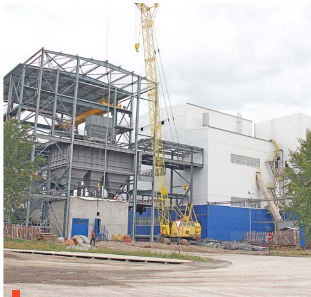
Строящаяся и уже действующая помольные мельницы
