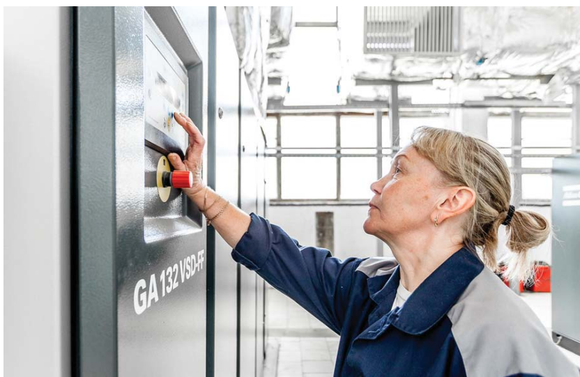
В новой компрессорной КЗФ
