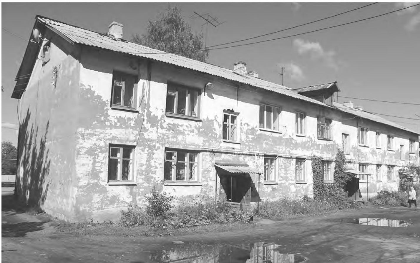
Ждёт ремонта ещё в этом, 2015 году, дом №23, по ул. Циховского
