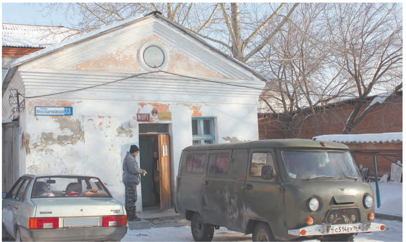
Фасад здания вообще не ремонтировали
