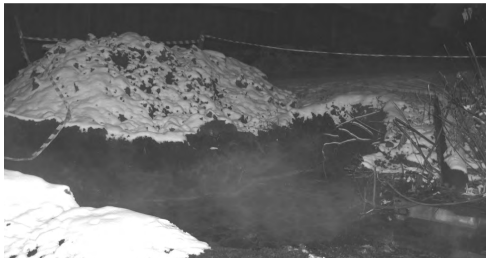
Прорыв теплотрассы по ул. Республики - 8 Марта
