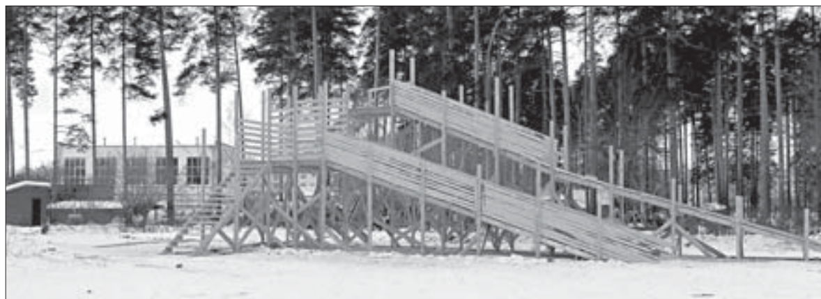
На данный момент в городском парке уже стоит деревянный каркас горки и тёплый туалет
