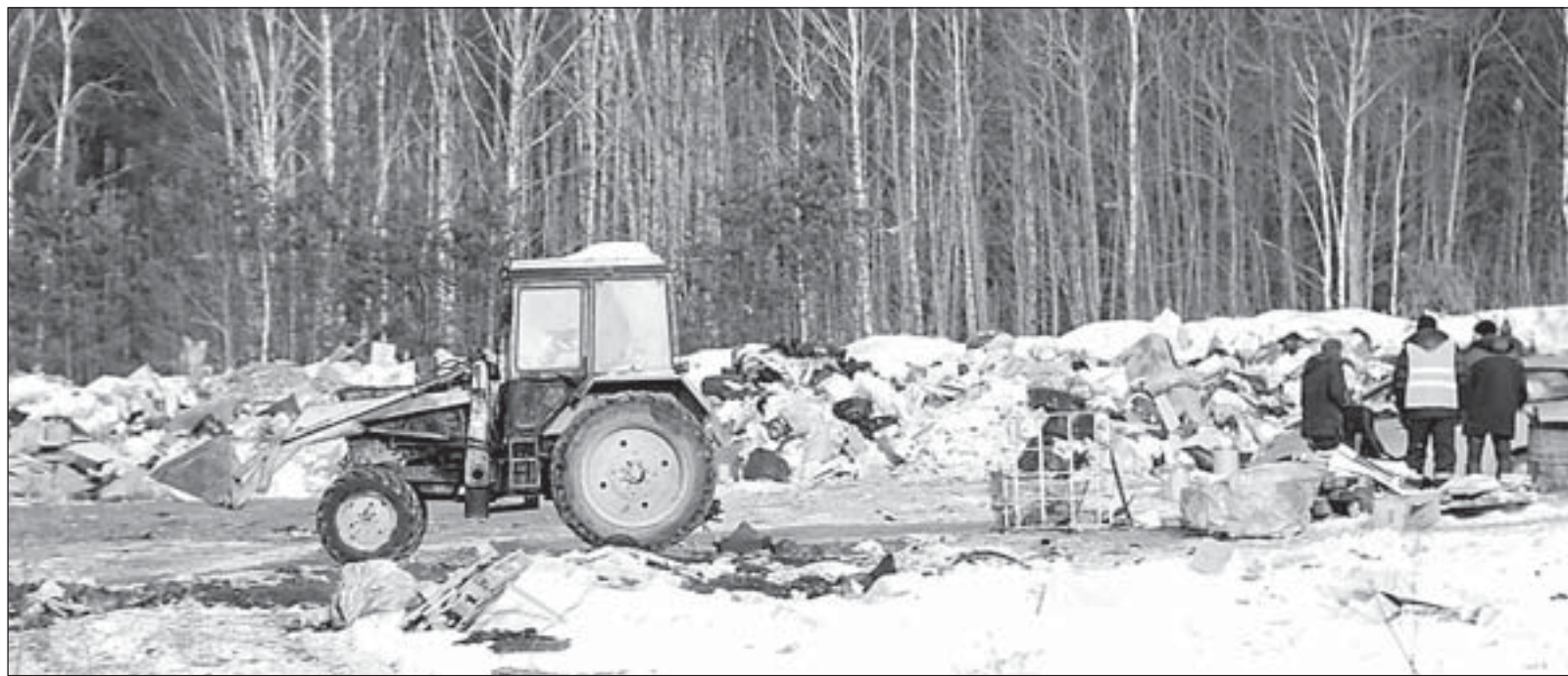
Согласно новой территориальной схеме свалка-полигон «Возрождение» будет использоваться как временная площадка для сортировки бытовых отходов. После сортировки мусор будет увозиться в Ревду
