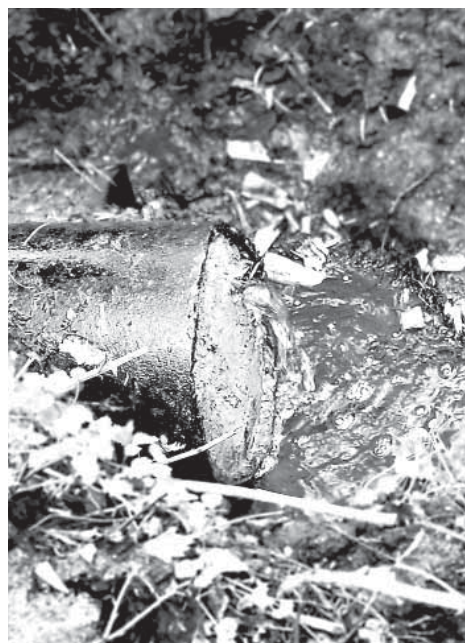
Спустя неделю стоки всё же выбили деревянную заглушку, из трубы снова потекла вода
