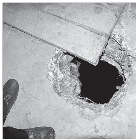
Состояние помещений в местах общего пользования – аховое. Сторожики утверждают, что ремонта там не видели
