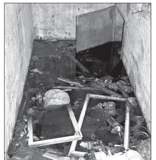
В подвал невозможно зайти даже в болотных сапогах. Помимо воды, он также заполнен мусором
