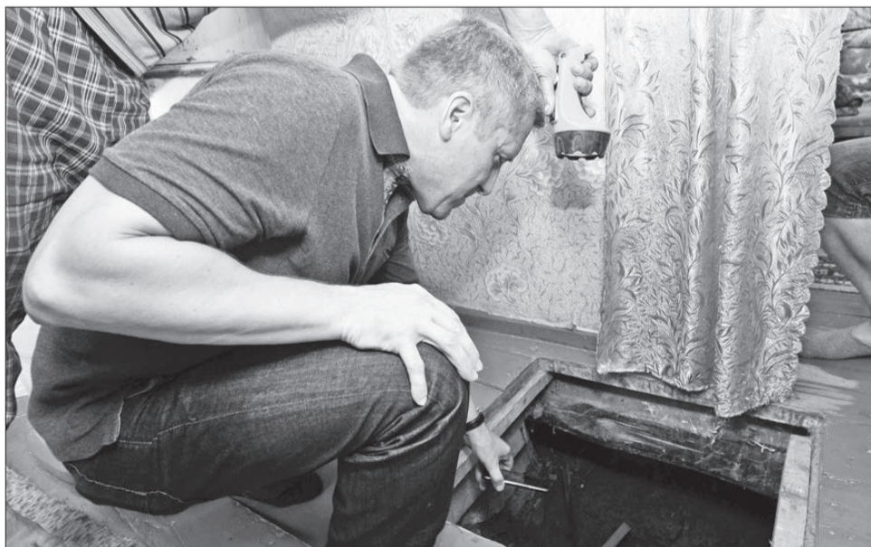
Первый замглавы администрации Валерий Хорев осматривает подпол дома №19 по улице Димитрова: вода ушла
