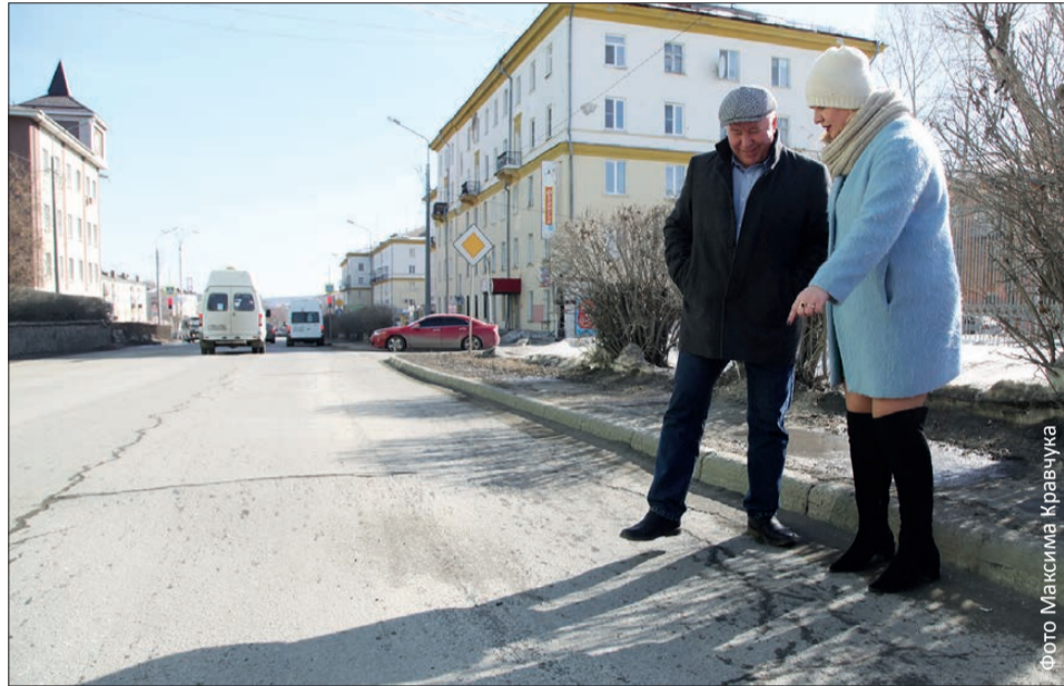
Участок дороги на пр. Ильича просел - подрядчиком придется выполнить гарантийный ремонт
