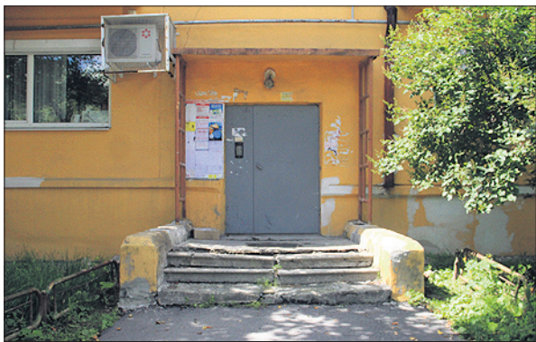
Неотремонтированный подъезд Тейтельбаумов.
