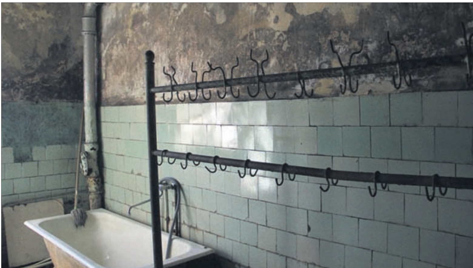
Душевая в общежитии на Мамина-Сибиряка, 10 напоминает декорации к фильму ужасов: повсюду сырость, плесень и ржавчина, картинку дополняет непонятная конструкция с крючьями.
