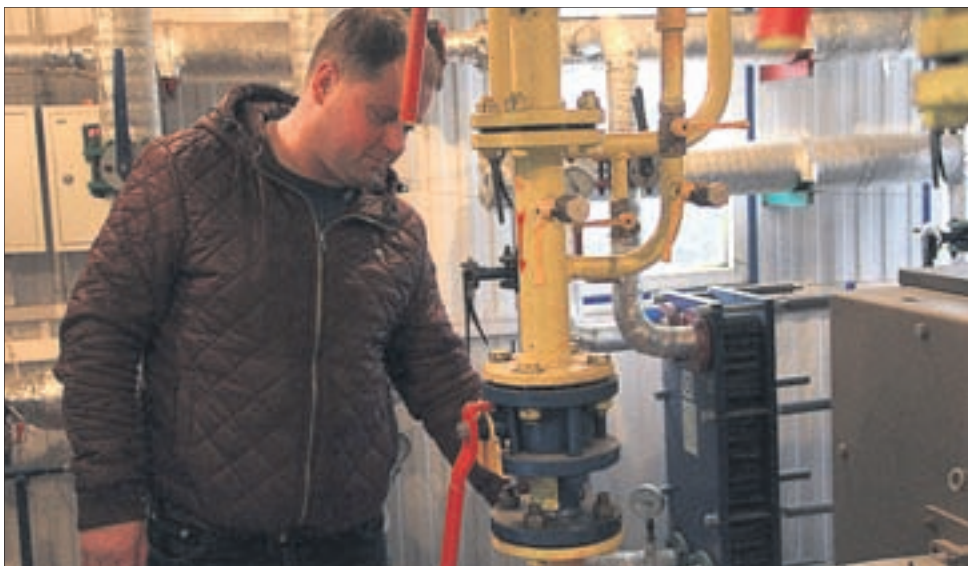
Сейчас, по словам Юрия Прохорова, убыточных котельных в Первоуральске нет. Для этого пришлось полностью модернизировать имеющиеся и от топки углем перейти на газ. Новые модульные здания, новое оборудование, большие мощности. Также отказались от труда человека, полностью автоматизировав процесс: больше нет пары рабочих, кидающих уголь в топку, а есть диспетчерский пульт. Например, котельная в Новоалексеевском отопляет школу, детский сад и частный сектор (который топить не выгодно). Котельная в Шайтанке полностью обеспечивает теплом частный сектор.
