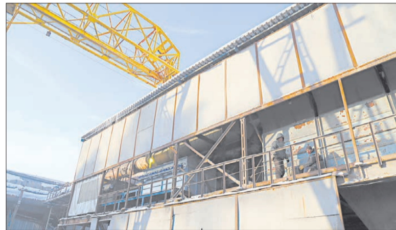
Рабочие монтируют систему очистки на одном из производственных участков, на другом аналогичные работы запланированы на 2017 год. Новые фильтрующие установки рукавного типа обеспечат улавливание 99% вредных веществ
