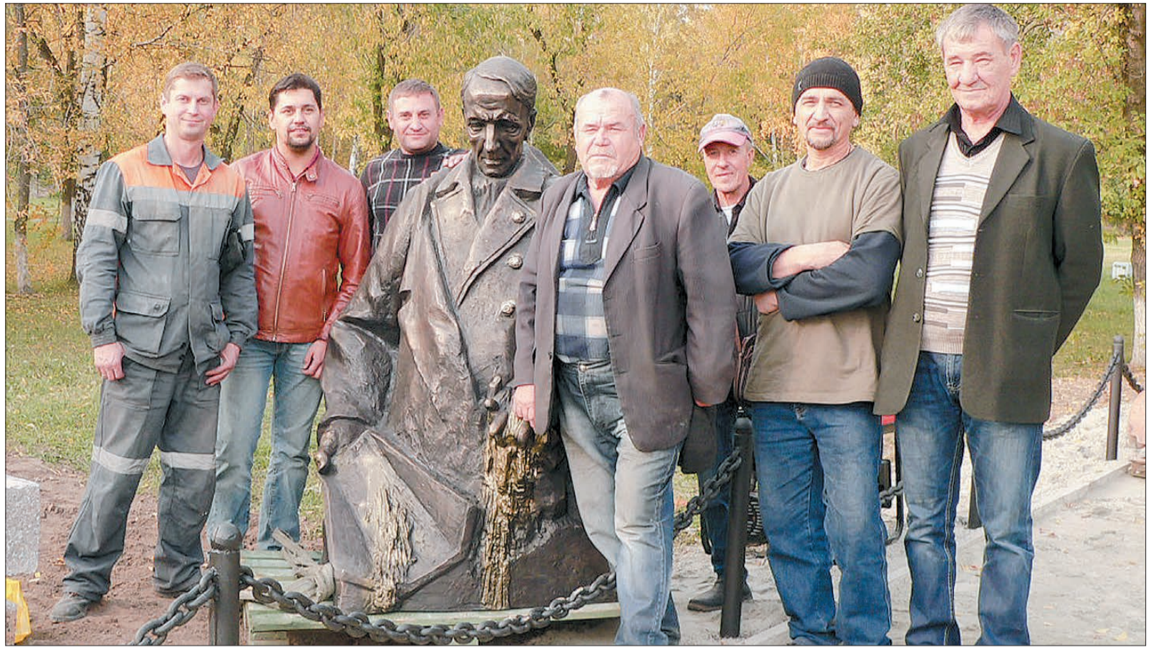
Перед началом монтажа памятника. Слева: директор компании «Благовест» Игорь Митряев, руководитель регионального фонда «Мир золота» Евгений Лобанов; в центре: скульптор Константин Грюнберг; справа налево: руководитель общестроительных работ Владимир Вялов, скульптор по камню Айрат Маглиев. Фото Михаила Лебедева
