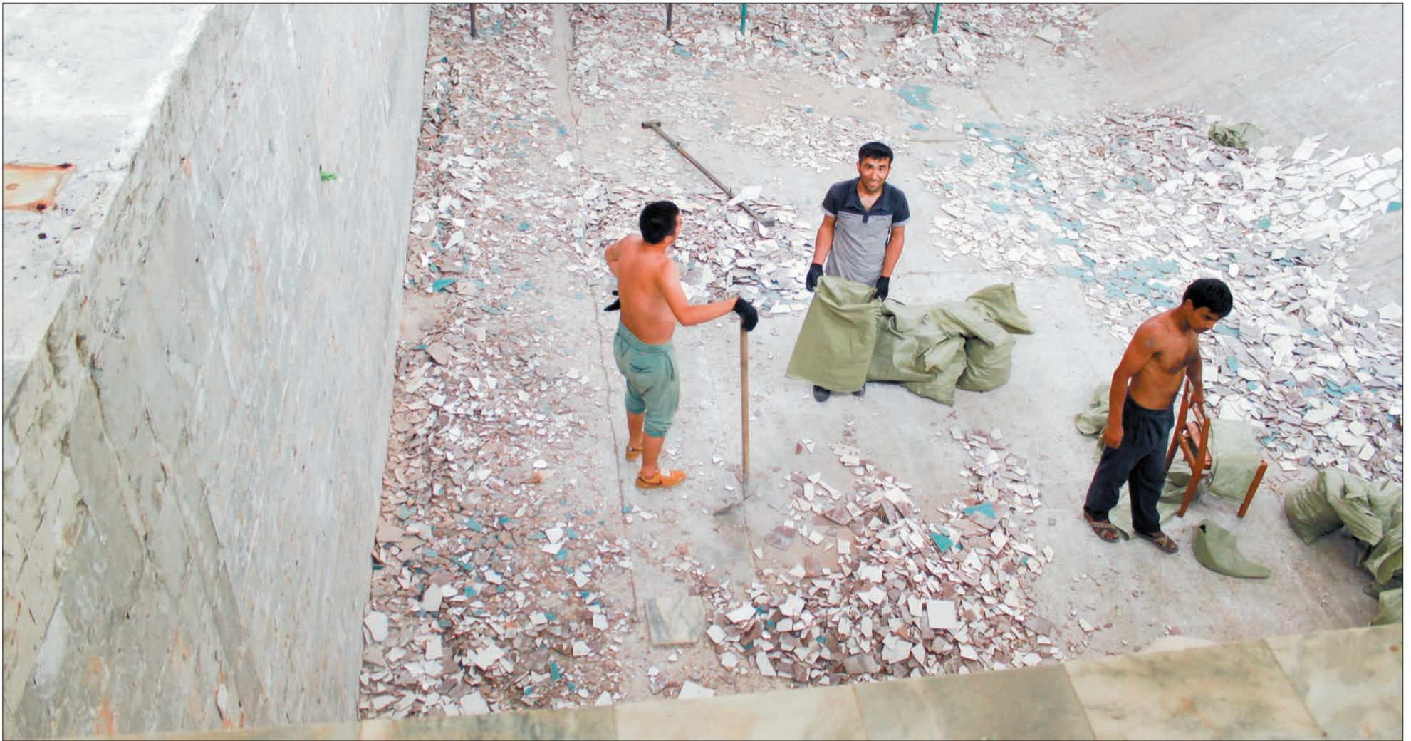
Все, кто менял плитку в ванной, содрогнулись бы, увидев масштабы работ в бассейне. Фото Валентины Завойской
