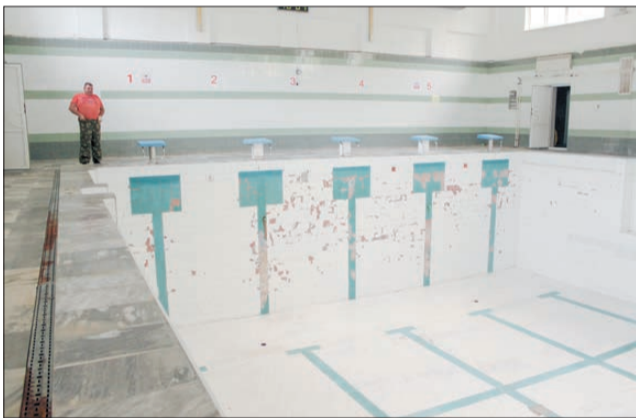
Чаша бассейна после слива воды и осушения выглядела очень потрепанной – то, что скрывала вода, теперь оказалось перед глазами
