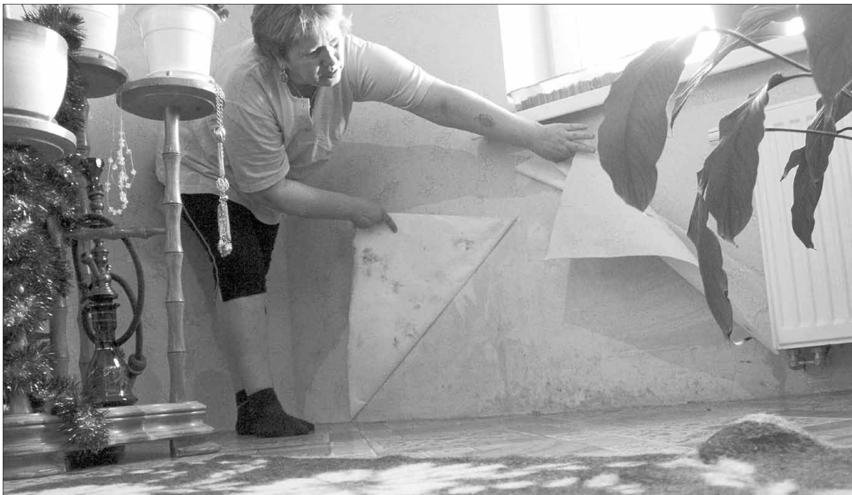
Любовь Дулова показывает последствия гидроизоляции. По словам березовчанки, она не раз переклеивала обои в квартире и до сих пор не может полноценно прожить в купленном год назад жилье. Фото Павла Шабельникова
