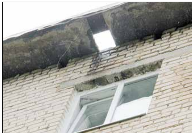
В кровле над квартирой Тамары Петровой зияет огромный дыра. Фото Олега Манварова
