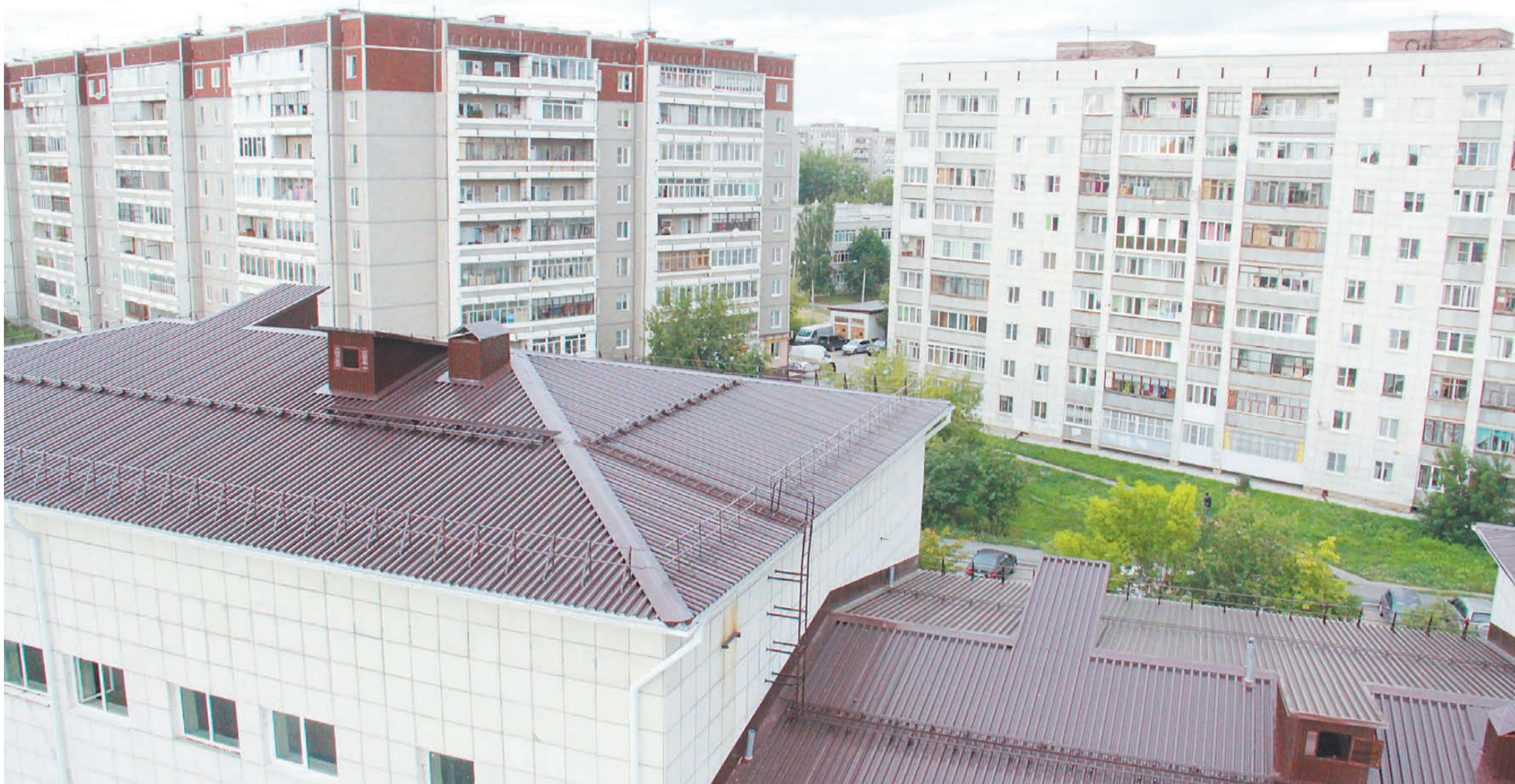
Новая крыша спортшколы «Олимп» оборудована снегозадержателями и ограждением, вид на ул. Брусницына. Фото Олега Манварова
