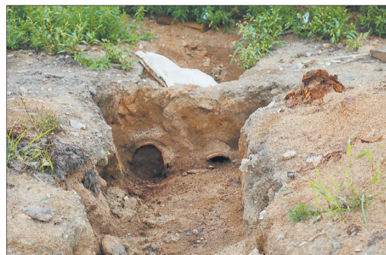
Чугунные трубы старых очистных сооружений неизвестные охотники за чёрным металлом сковырнули и увезли. Фото Павла Шабельникова
