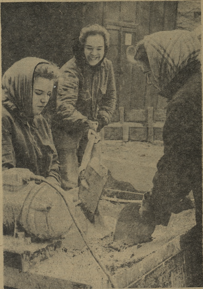
Комплексная бригада отделочников СУ-4 треста «Уралтяжтрубстрой» тов. Коновалова работает на отделке бытовых трубоэлектросварочного цеха Старотрубного завода. Соревнуясь в честь 1 Мая, мартовское задание она выполнила на 118 процентов.
