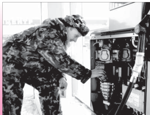
Через фильтр тонкой очистки топлива на резервуаре - наше ноу-хау - бензин поступает на входной фильтр ТРК и, наконец (!), через пистолет, в котором также установлен фильтр из мелкой сеточки, заливается в бак Вашего автомобиля
