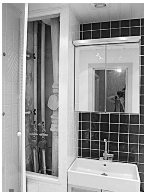
Доступ к общедомовым канализационным стоякам и стоякам водоснабжения должен быть свободным
