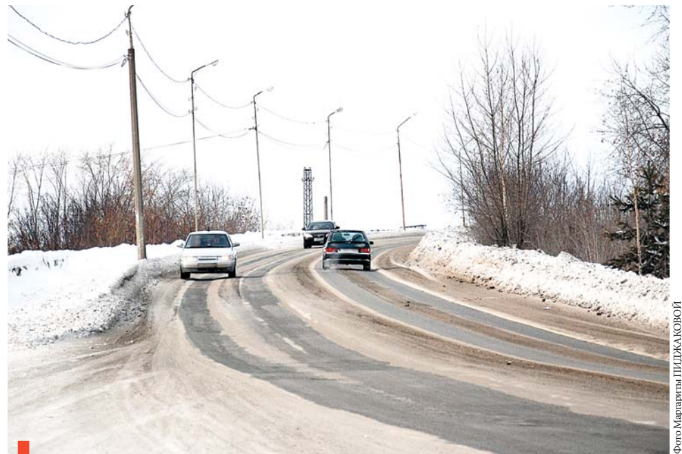
Путепровод над железнодорожными путями требует ремонта
