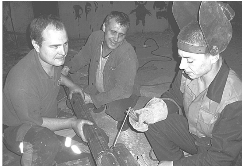
Монтаж теплоцентрали на Тимирязева, 3, ведут работники ООО «МЖК» А.А. Устюжанин, Ю.И. Микушин и П.С. Свалов.
