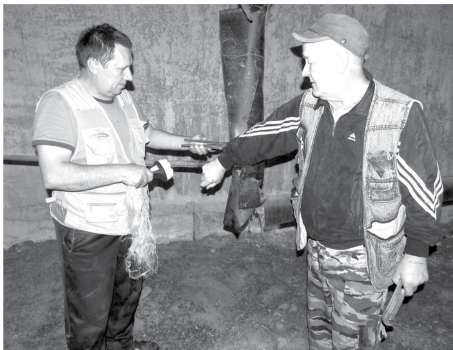
Замену спускных клапанов центрального отопления проводят работники МУП «Городская УК» Николай Васенёв и Михаил Сунцов.
