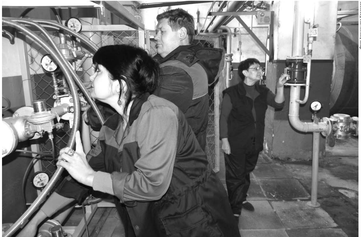
Розжиг котла №2 производят работники котельной №1 БУП «БТС» Ольга Кузнецова, Сергей Башков и Татьяна Кочегарова.
