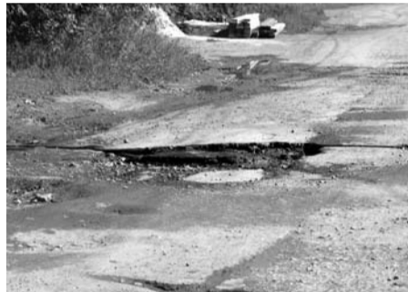
Участок дороги на улице Крылова, требующий ремонта.
