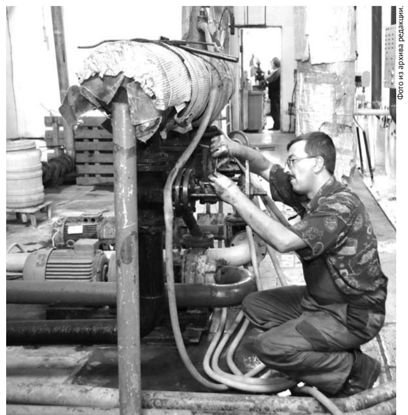
Ремонт запорной арматуры в котельной №5 выполняет Алексей Прохорин. По утверждению Владимира Трачука, в домах, которые обслуживаются этой котельной, пока не планируется отключать ГВС.
