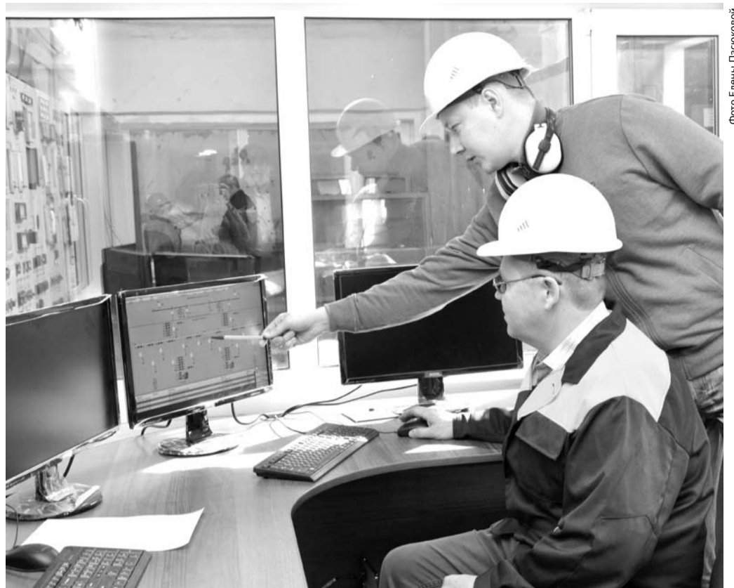
На пульте управления газогенераторными агрегатами №№ 1 и 2 за процессом следят начальник смены Олег Тушков и начальник котельной Виктор Осинцев.
