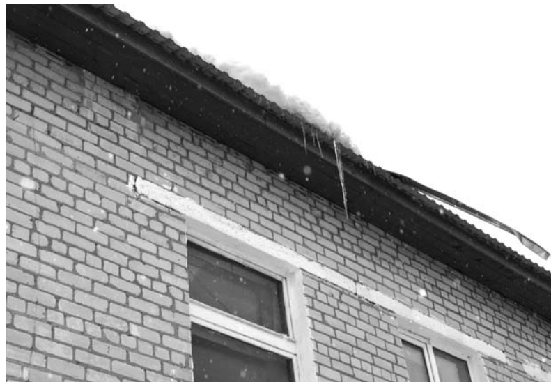
На доме, отремонтированном «варягами», рушится кровля.
