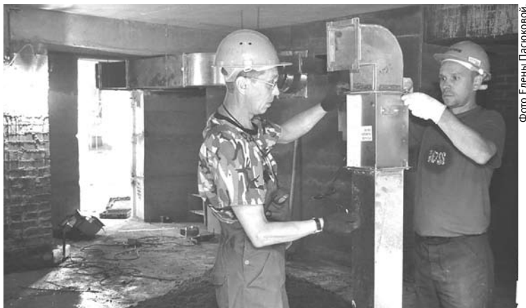
В скором будущем горожане смогут плавать в бассейне, но пока здесь полным ходом идет строительство. Монтажники Денис Васильев и Александр Овчинников ведут монтаж канального вентилятора.
