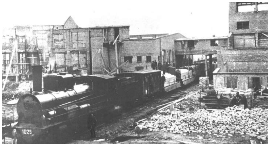
Строительство помольного (слева) и прессового (справа) цехов Богдановичского шамотного завода. 15 октября 1934 год.
