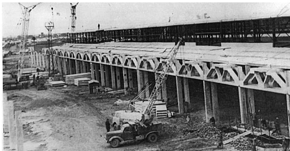
1970 год. Идет монтаж главного корпуса Богдановичского фарфорового завода. В 2009 году БФЗ был остановлен.
