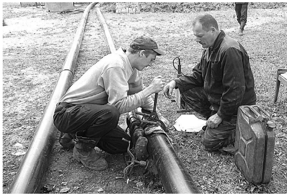
Работники цеха водопроводных сетей ООО «Водоканал» Иван Лаур и Владимир Афанасьев ведут монтаж водопроводной сети между домами №11 и №13 3 квартала.
