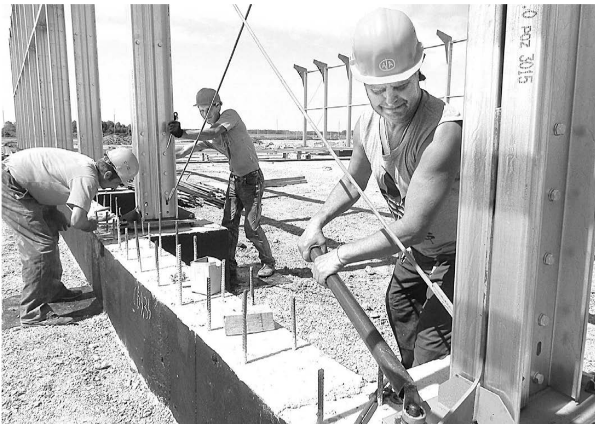
Рядом с существующими корпусами СК «Уральский» ведут работы по увеличению площадей предприятия.
