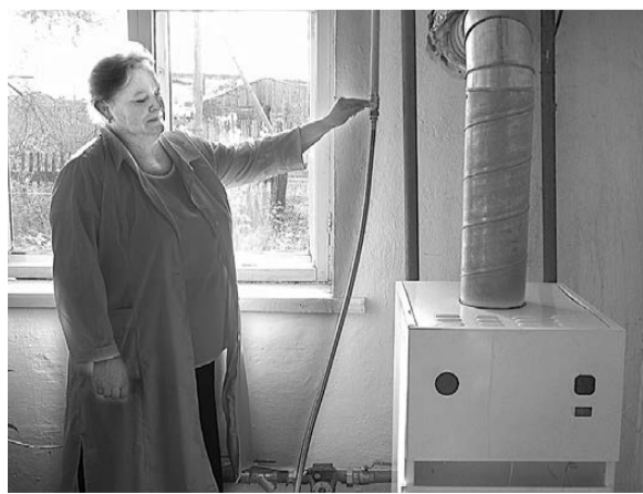
Заведующая ФАПом Л.А. Тюленева довольна тем, что в ее учреждении установлен газовый котел.
