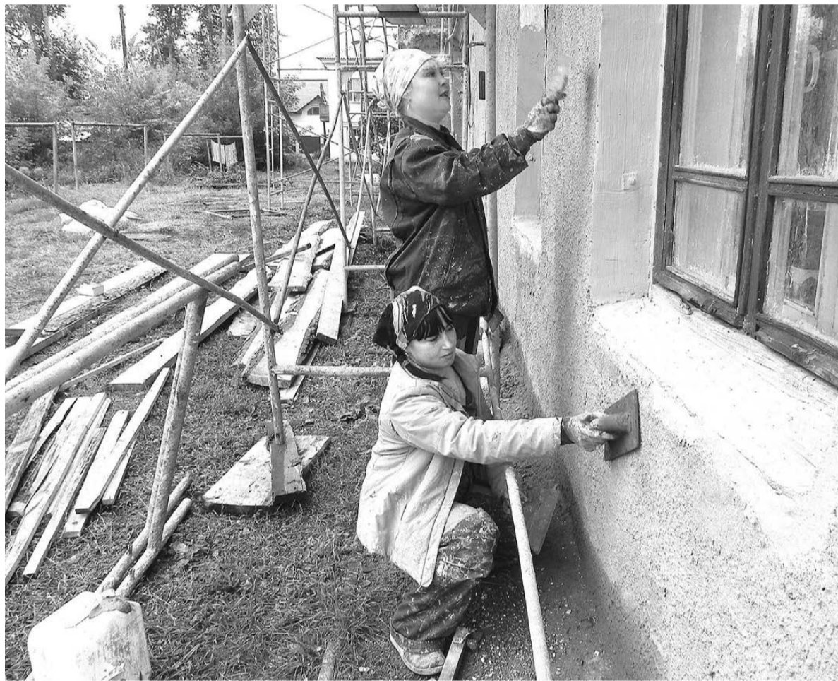
Работницы ООО «Управдом» Е.И. Качусова и Т.М. Гуртовая ведут ремонт фасада дома № 9 на улице Мира.
