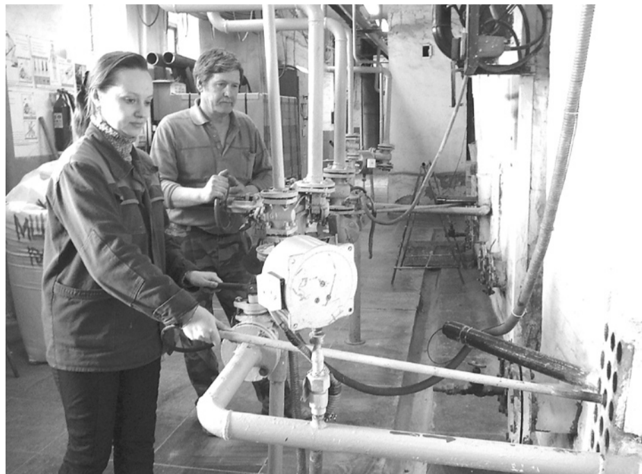
Операторы котельной № 3 ООО «ТЭК» О.В. Вторых и В.И. Кузнецов на розжиге котла № 1. Фото А. КОЛОСОВА.
