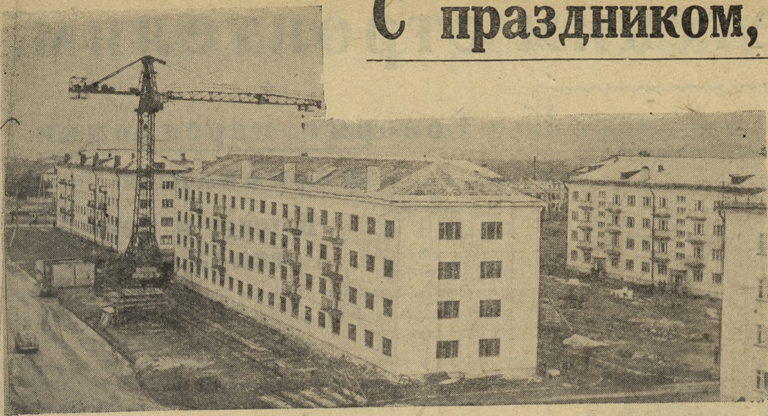
На снимке: общий вид строительства дома во втором квартале Соцгорода. Фото А. Арчажникова.
